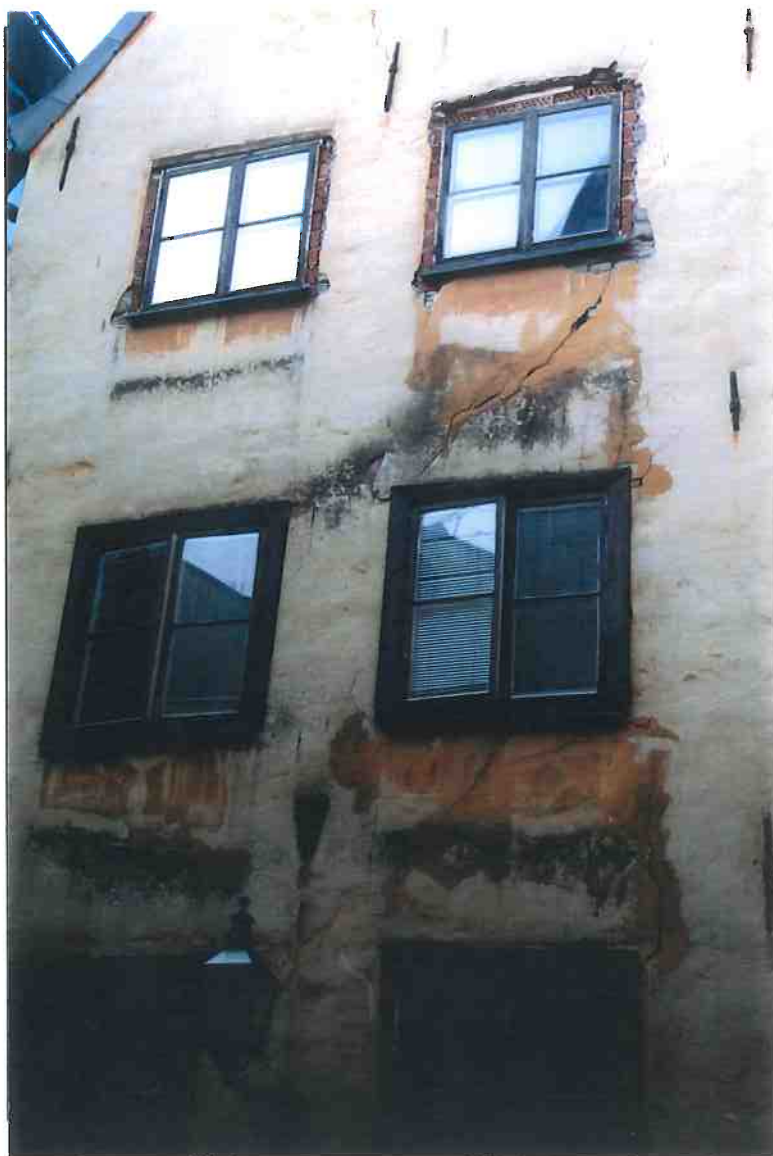
F5/11. Detalj av husets norra gavel mot Brandplan. De enkla raka ankarsluten är från 1700-talet, den triangulära från en förstärkning under 1900-talet. Sprickbildningen avslöjar sättningar i husets västra mur. Översta våningen visar spår efter den påbörjade fönsterinsättningen, där bytet felaktigt utfördes inifrån med som följt skador i fönsteromfattningen.
