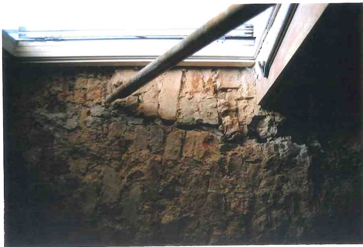
F5/26. Som en följd av sättningen är sammanfogningen är bruten mellan västra yttermuren och södra tvärmuren i trapphuset.
