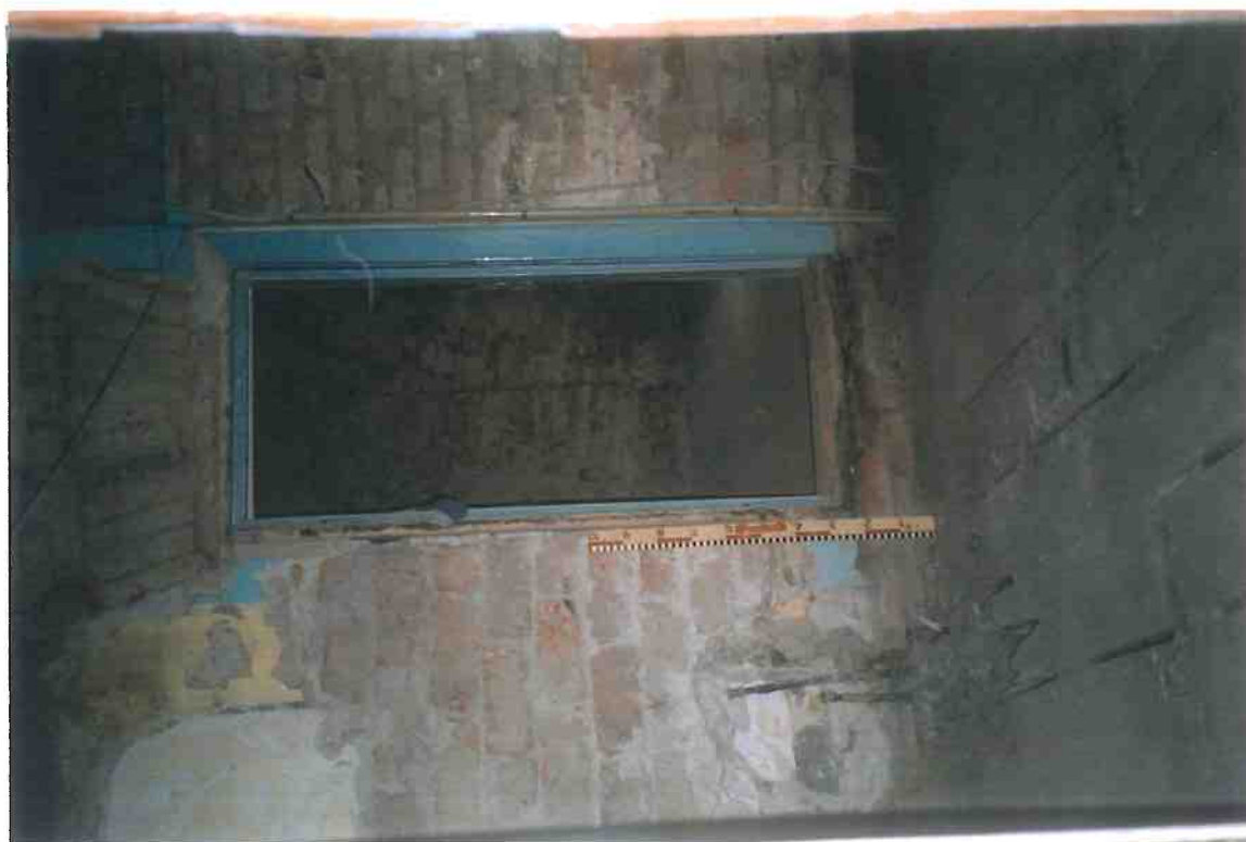
F4/19. Rum 402. Dörröppning mot rum 401. Den bortknackade putsen avslöjar murverkets lappverk. Vänster om dörren stortegel, ovanför dörröppningen en avlastningsbåge. Nedanför dörren till vänster rörstammarna.
