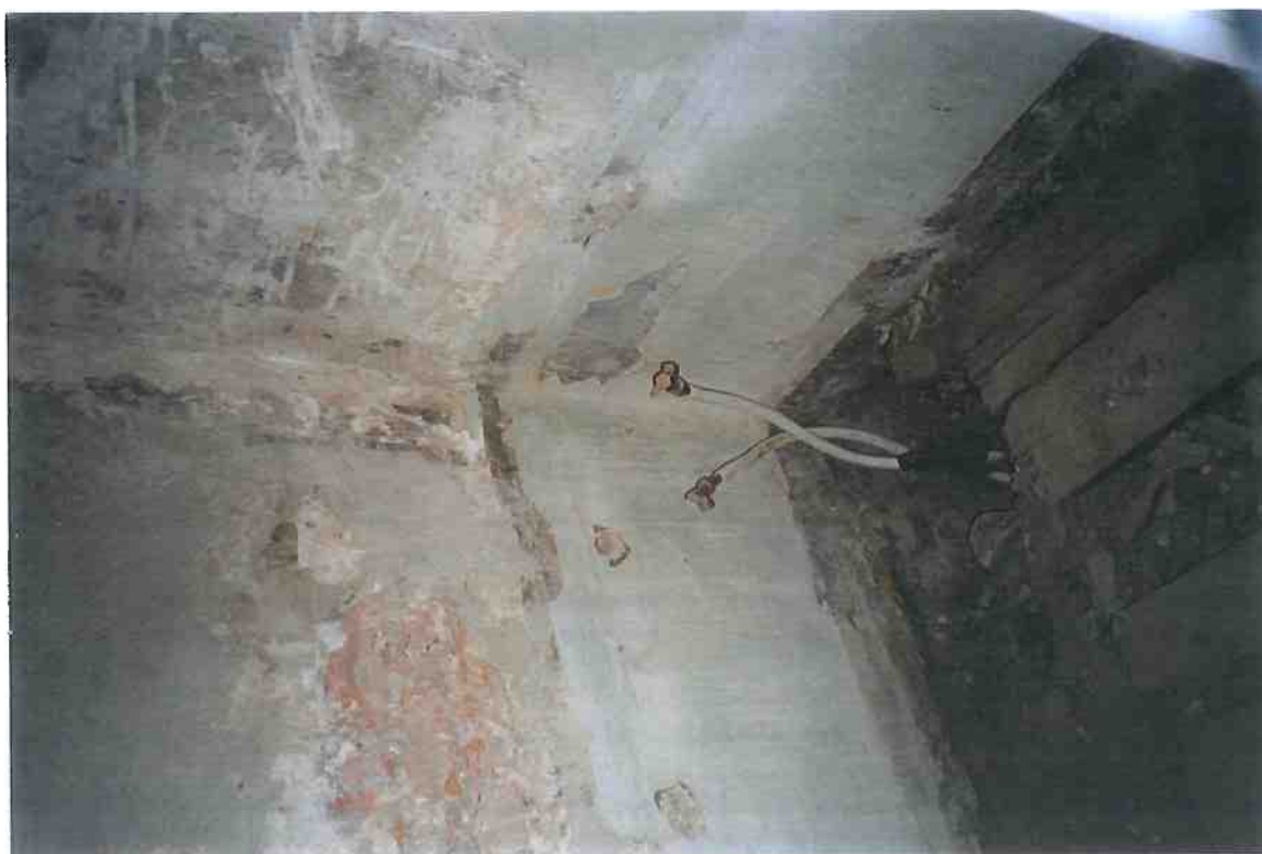
F4/16. Rum 401. Stangenombrott i golv och bjälklag i rummets SO-hörn med medförande skador.
